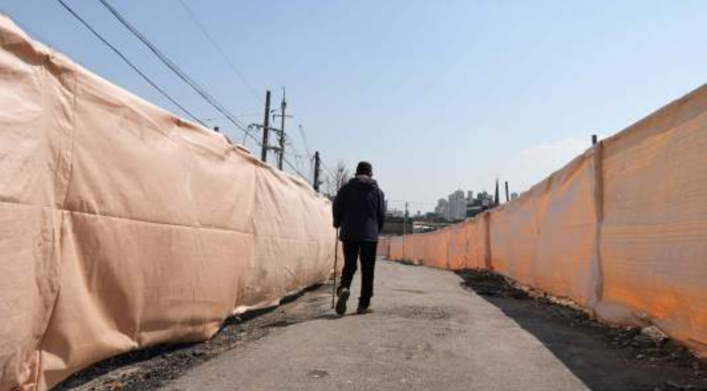
❖ 어느 날 집 주변에 가림막이 높게 쳐졌다. 서둘러 우리 집을 삼베로 염(염)을 하듯 둘러쳤다. 곡(哭) 소리가 들린 지 오래되었다. (청천동)
